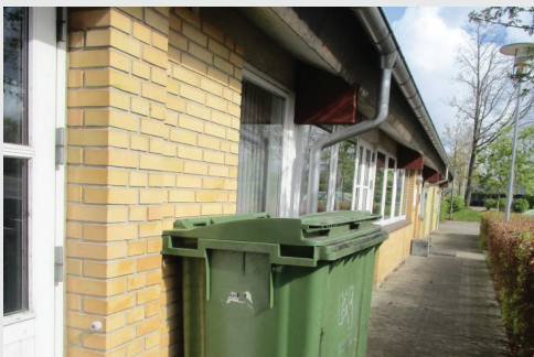
Kritisk forhold: for tæt på bygning og under tagudhæng
