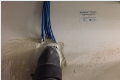
Rørgennemføring korrekt udført.
