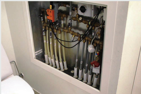
Teknikskab med fordelerrør. Materialesammensætning medførte korrosion og melderør var ikke monteret, så læk umiddelbart kunne opdages.
